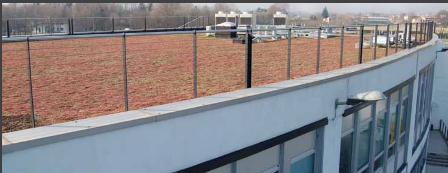
fig. 1) Giardino pensile estensivo realizzato con DRAINROOF - Centro Direzionale Ospedale dell'Angelo Mestre - VE. Extensive green roof created with DRAINROOF - Main offices of Ospedale dell'Angelo hospital, Mestre, Italy.
