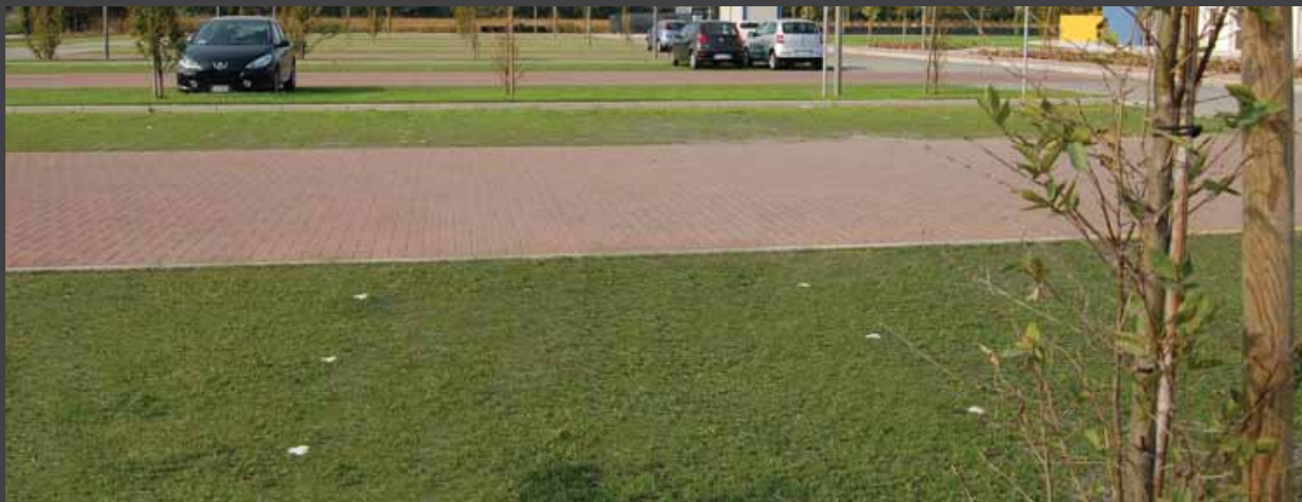
fig. 3) Parcheggio inerbito completato ed in uso. View of the finished carpark in use.
