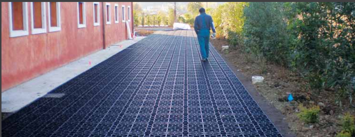
fig. 1) Realizzazione di camminamento perimetrale con GEOFLO ® - Edificio Residenziale - Costabissara - VI. Creation of a green walkway with GEOFLO ® - Residential development, Costabissara, Italy.
