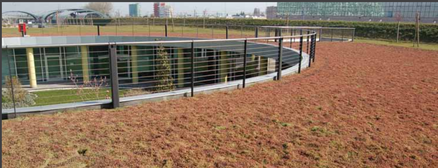
fig. 3) Giardino pensile estensivo realizzato con DRAINROOF completato. Completed extensive green roof created with DRAINROOF.
