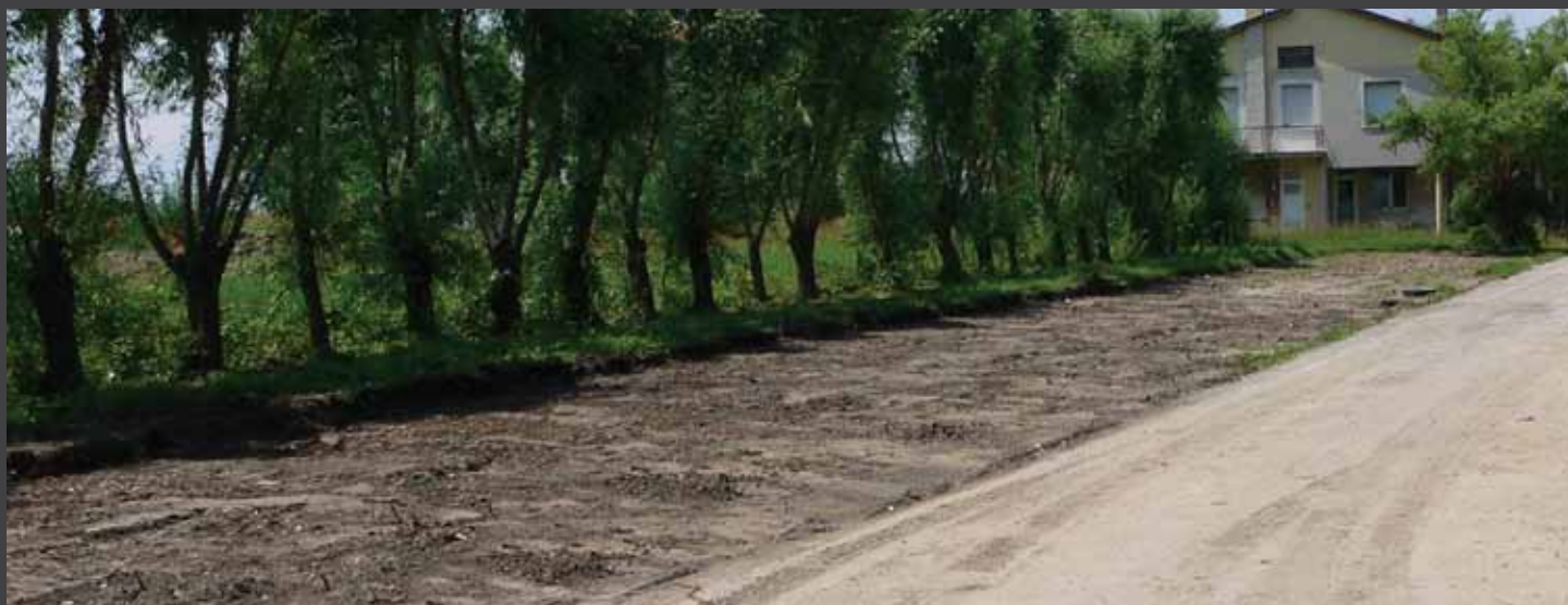
fig. 1) Realizzazione del fondo di preparazione per parcheggio di un complesso sanitario - Istituto di Cura San Camillo - Lido di Venezia - VE. Preparation of the subgrade the green carpark - Istituto di Cura San Camillo clinic, Lido di Venezia, Italy.
