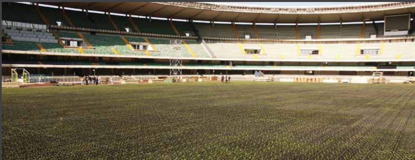
fig. 3) Area del campo sportivo con posa GEOFLO® ultimata. Sport field fully protected by GEOFLO®.
