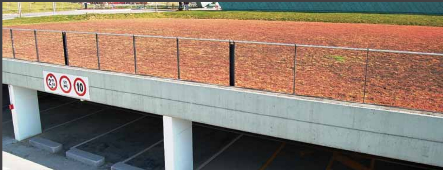
fig. 3) Giardino pensile a Sedum di garage interrato - Fondazione Banca degli Occhi del Veneto - Mestre - VE. Green roof with Sedum over an underground garage - Fondazione Banca degli Occhi del Veneto, Mestre, Italy.
