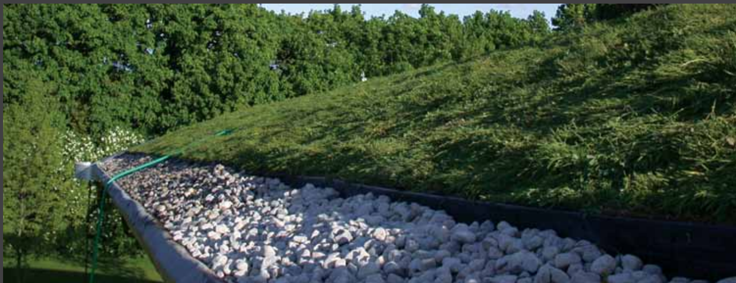
fig. 3) Particolare della finitura con esecuzione di un corridoio di ghiaia per regolare il convogliamento idrico. Detail of the green roof with a gravel border to regulate water flow.
